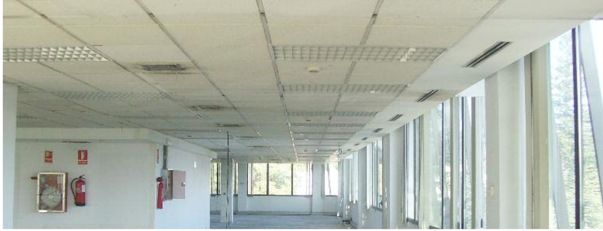
Techo sucio antes del tratamiento Reciplac
